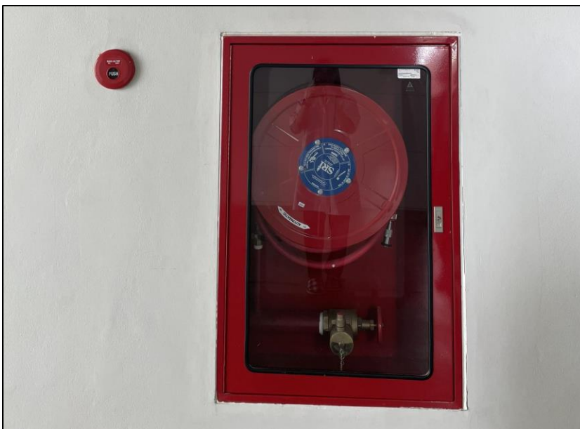
อุปกรณ์ดับเพลิง
